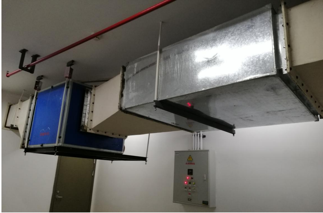
风机减振吊钩吊挂及消声器
